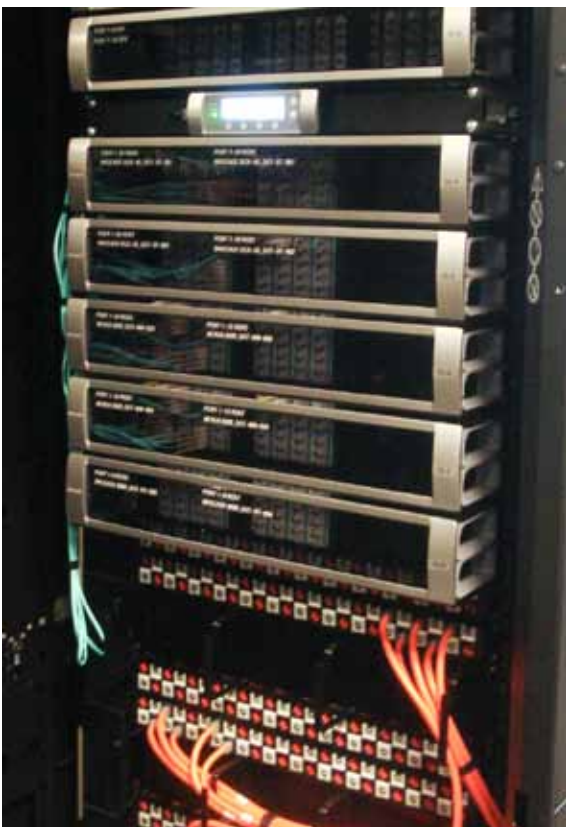
Bild 2 Intelligente Echtzeitkontrolle. Quelle: CommScope Solutions
