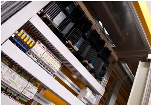
Die neuen Einbauten in die bestehende Verteilung des Hörsaals
